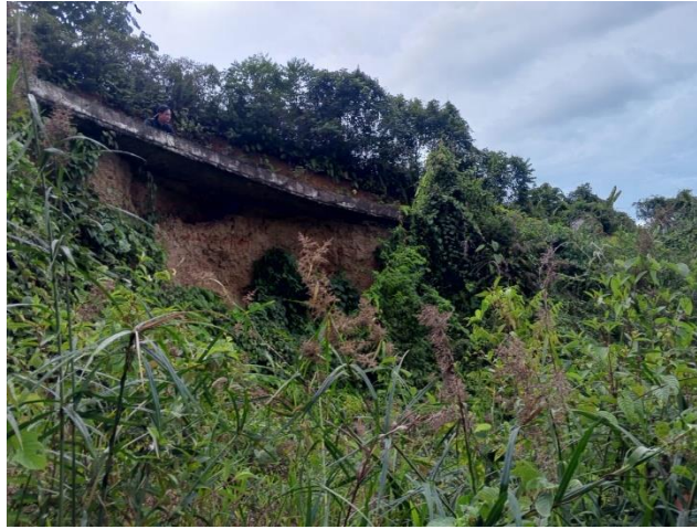
Gambar 5. Gambar Lokasi Longsor kondisi dari bawah
