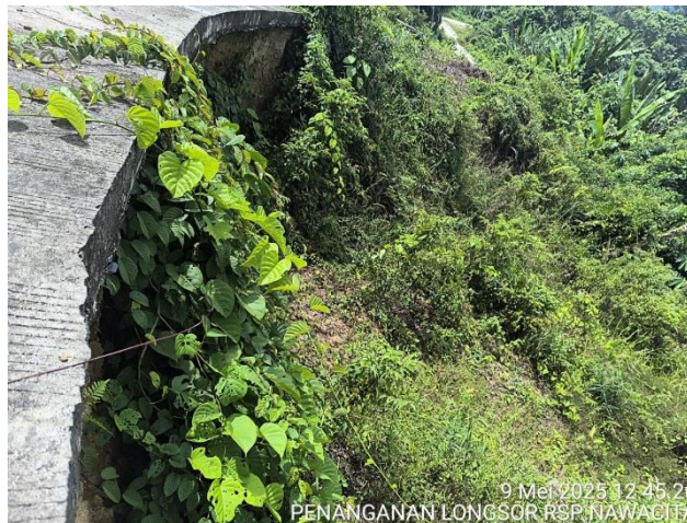
Gambar 4. Gambar Lokasi Longsor
