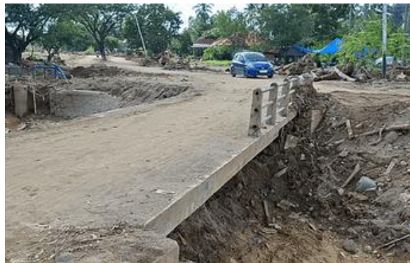
Gambar 3. Kondisi Jembatan Irigasi 1 setelah galodo bulan November 2025
