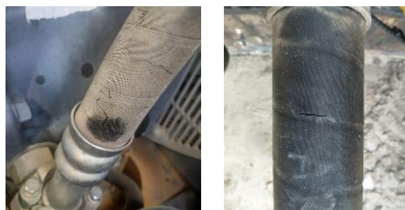
Gambar 5. Crack pada Hose Hidraulik.
